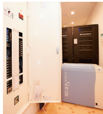
院内に設置された 「Personal Energy (パーソナルエナジー)」。 小型の独立電源システムだ
