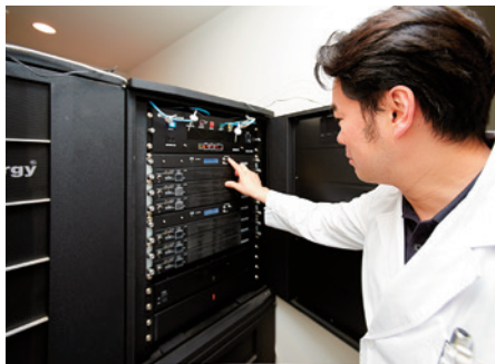
パーソナルエナジーの稼働状況を点検する
